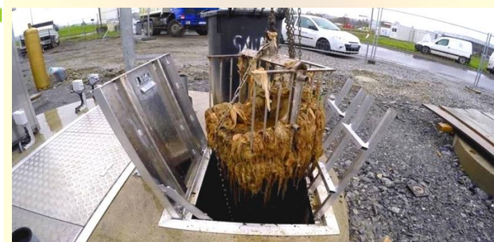
Panier de dégrillage de la station d'épuration d'Assat-Bordes
