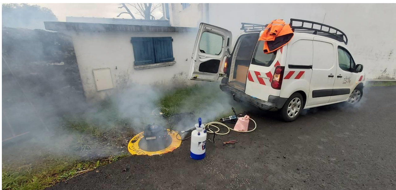
Essais au fumigène depuis le réseau principal sur un branchement d'assainissement non conforme à Asson (gouttières raccordées sur le réseau d'eaux usées)
