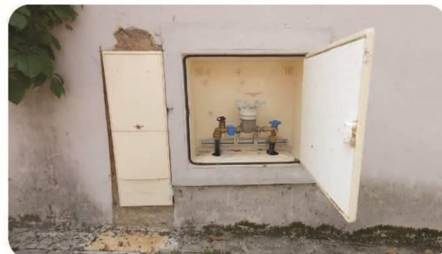
Niche murale du compteur d'eau (à droite) et coffret ENEDIS (à gauche)
