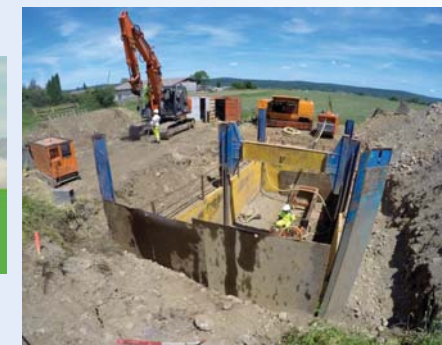
Pose de conduites eau et assainissement sous la voie ferrée à Mirepeix
